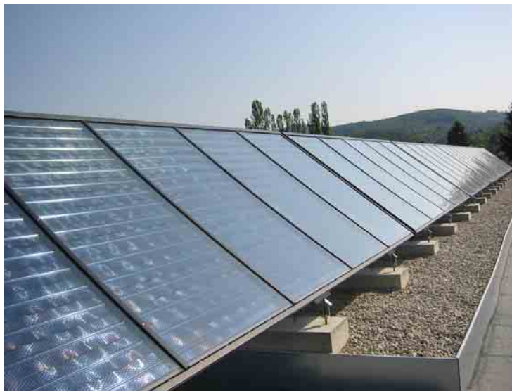
Thermische Solarkollektoren auf einem Wohnhaus 4
