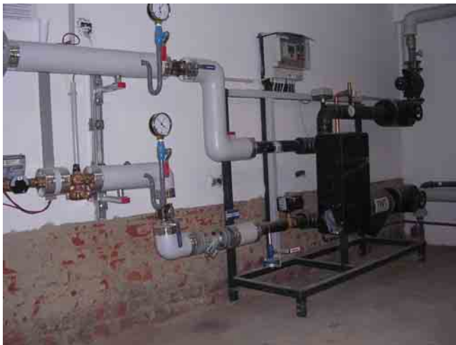
Abb. Fernwärmeübergabestation im Keller
