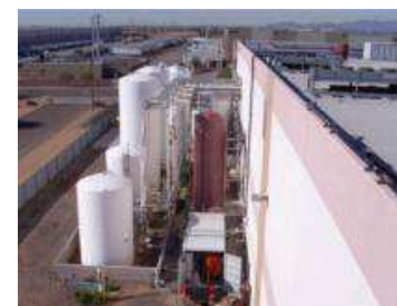
Solare Prozesswärme Gatorade (USA) installiert durch SOLID
